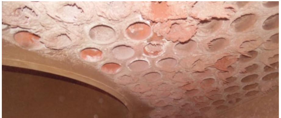
9 pav. Apatinės rėtinės vaizdas. Apnašų spalva rodo, kad pelenuose yra geležies oksidų. Apnašų išsidėstymas sluoksniais – raudona ar balta spalva – rodo, kad korozija vyko ne visą laiką
