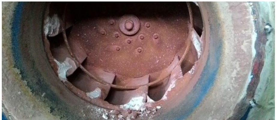
12 pav. Rusvos spalvos apnašos dūmsiurbyje indikuoja katile vykstančią koroziją 1
