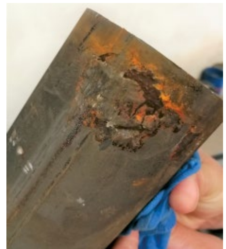
5 pav. Kiaurinė vamzdžio korozija prie pat apatinės rėtinės, šioje vietoje metalo temperatūra buvo žemiausia
