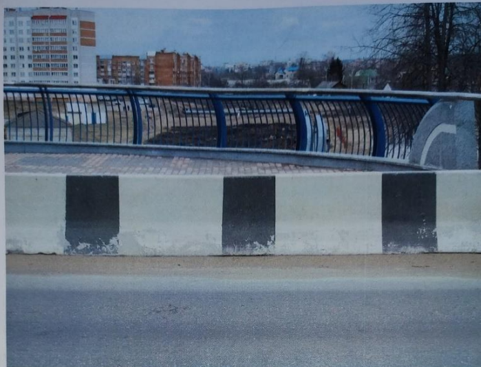
Рис. 2. Состояние покрытия на контрольном образце через год эксплуатации.
