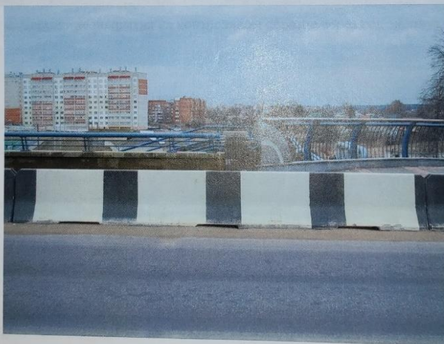
Рис. 1. Состояние покрытия на бетонном образце, обработанном гидрофобизирующим материалом, через год эксплуатации.
