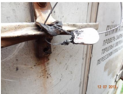
10 pav. Pažeista plomba
