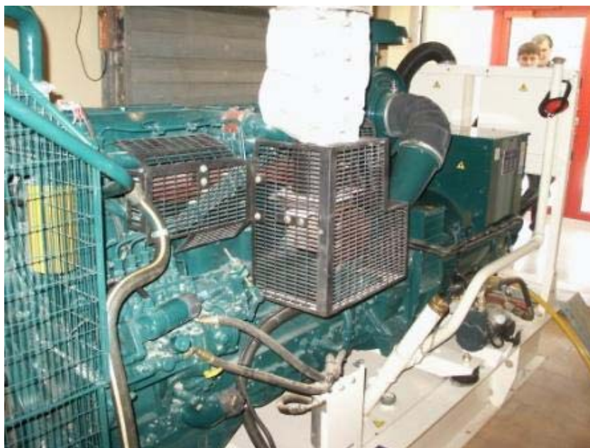
23 pave. Generatoriaus dešinė pusė.
