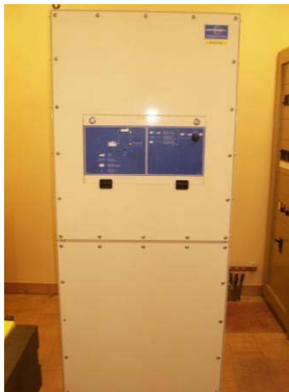
19 pave. Įtampos kontrolės panelė.
