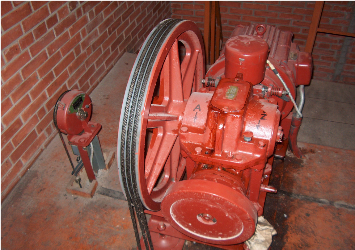
5.3.2.1.4 P2 pav. Kabinos ir priesvorio kėlimo mechanizmo įrenginiai
