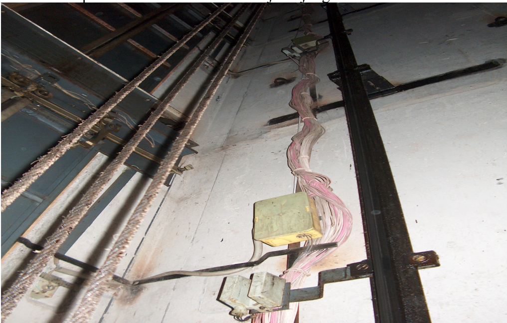
5.3.2.1.10 a P2 pav. Elektros paskirstymo skydai ir instaliacija
