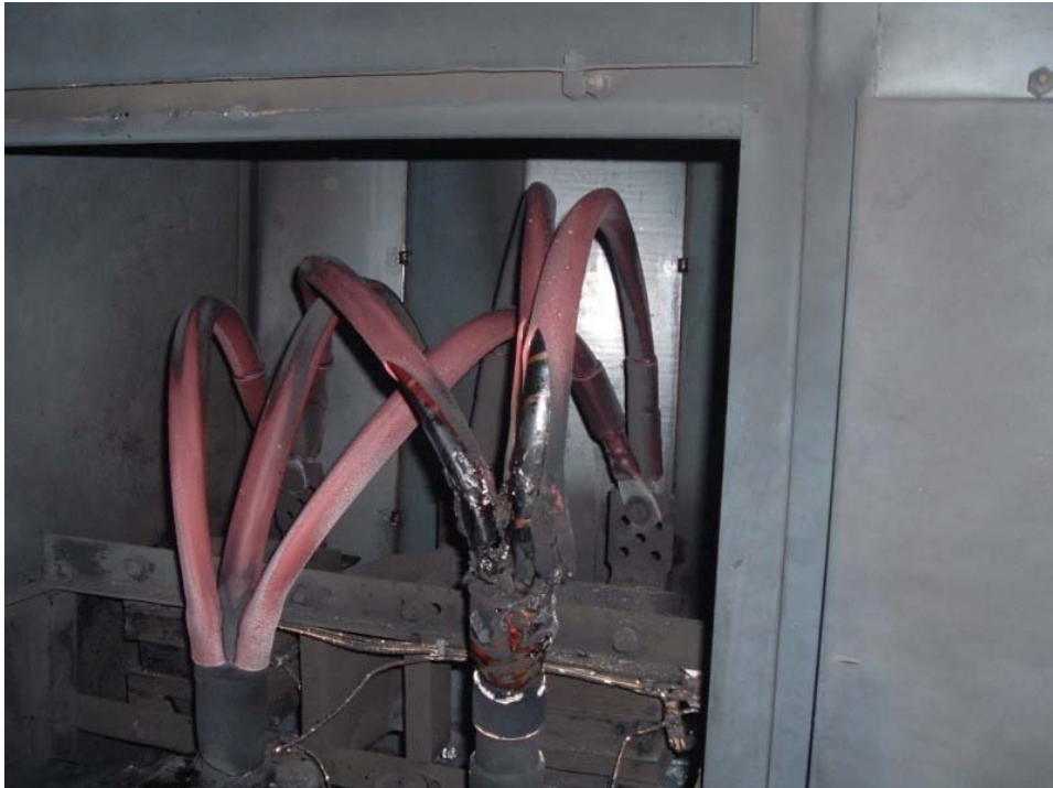
4.2 pav. Pažaida kabelio galūnėje
