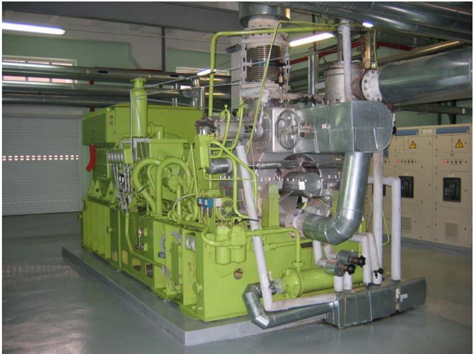
4 pav. Garo turbogeneratorius Nr.2
