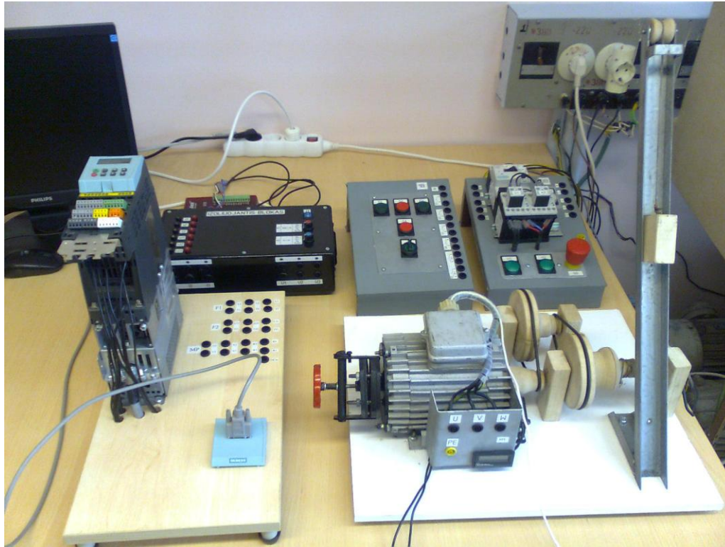
18 pav. Sumontuota elektros pavara su dažnio keitikliu
