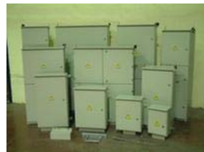
1.4 pav. Elektros energijos skirstymo ir apskaitos dėžės
