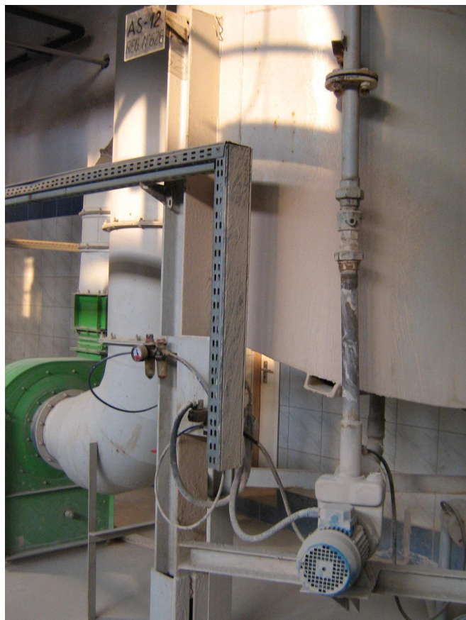
13 pav. Šlapio valymo filtras
