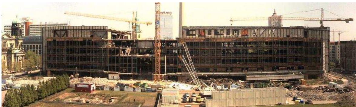
27 pav. Parlamento sprendimu išmontuojami Respublikos rūmai.(2006 gegužė). Išmontavimo darbus numatoma baigti 2007 m. balandį.
