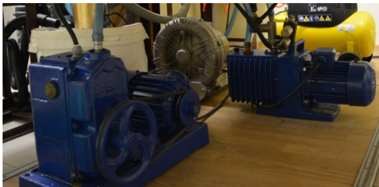
53 pav. Vakuuminių pompų sistema
