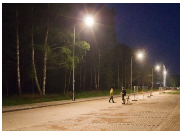
4.1 pav. Išmaniosios gatvių apšvietimo instaliacijos vaizdas.
